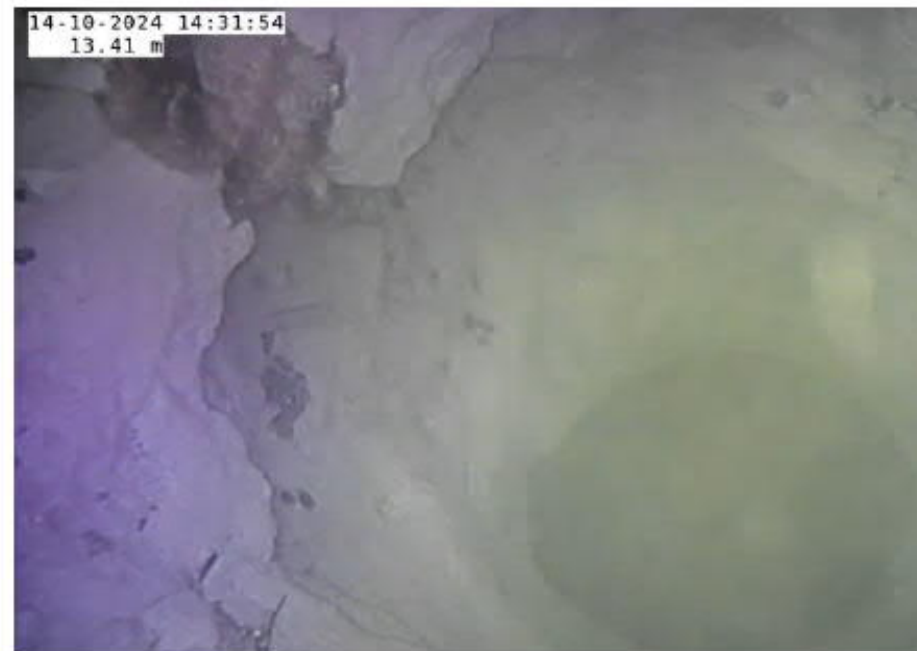
Pohled na kaverny v betonovém přechodu
